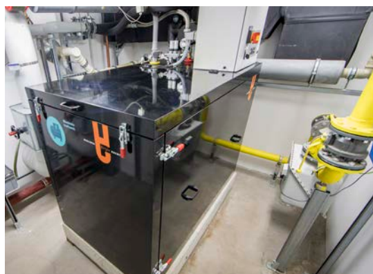
Blockheizkraftwerk im Heizkeller und Nahwärmenetz © ahnenenkel.com/Silke Reents
