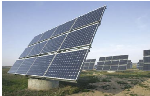
Abbildung 9: Der Solon-Mover: Eine nachgeführte Freiflächenphotovoltaikanlage. Quelle: Solon AG 2007.
